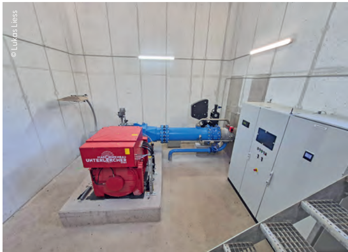
Bei vollem Wasserdargebot schafft die Turbine 135 kW Engpassleistung.
