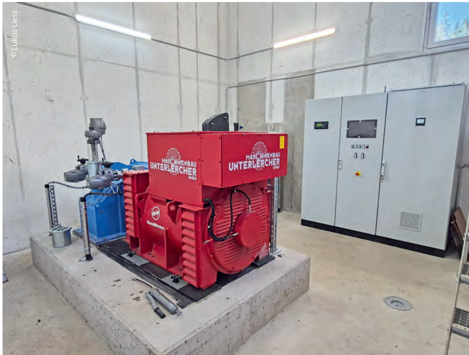
Der Maschinensatz von der Maschinenbau Unterlercher GmbH, bestehend aus einer Durchström-Turbine und einem Synchron-Generator, kann in einem breiten Betriebsband effektiv Strom erzeugen.
