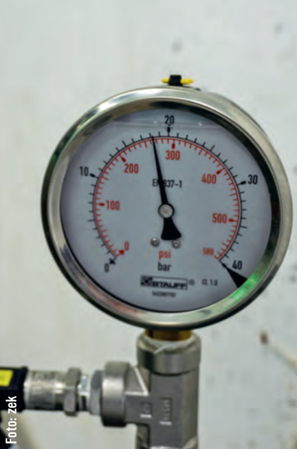
Das Pelton-Laufrad wird mit rund 18 bar Druck angetrieben.
