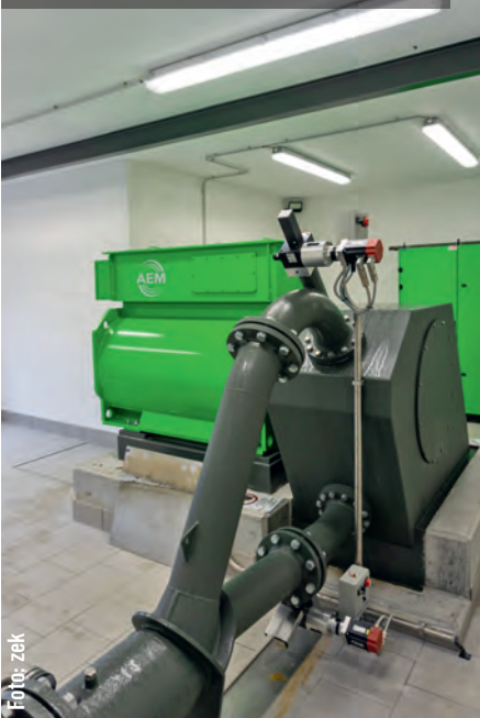
Zwei elektrisch angetriebene Stellmotoren sorgen für die exakte Regelung der beiden Pelton-Düsen.
