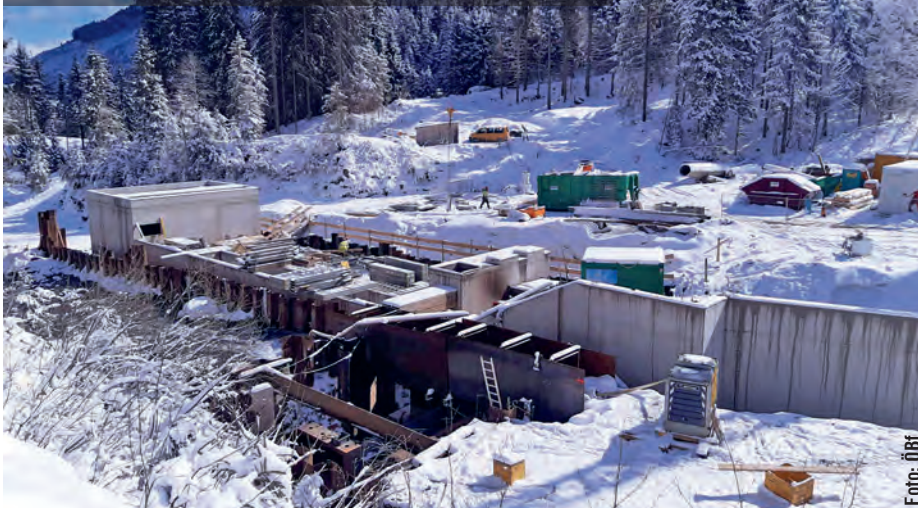
Die Wasserfassung wurde an der Einmündung des Frommbachs in die Langer Grund Ache errichtet. Eindruck von den Bauarbeiten im April 2021.
