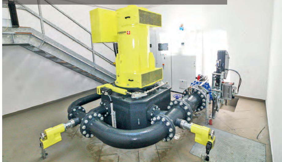
Das Herzstück des Kraftwerks Leimsbach lieferte die Osttiroler Maschinenbau Unterlecher GmbH, eine auf 150 l/s Ausbauwassermenge und 175 m Bruttofallhöhe ausgelegte 3-düsige Pelton-Turbine. Als wirkungsgradstarke Energiewandler kommen bei beiden Anlagen insgesamt drei Synchron-Generatoren vom Linzer Traditionsbetrieb Hitzinger zum Einsatz.
