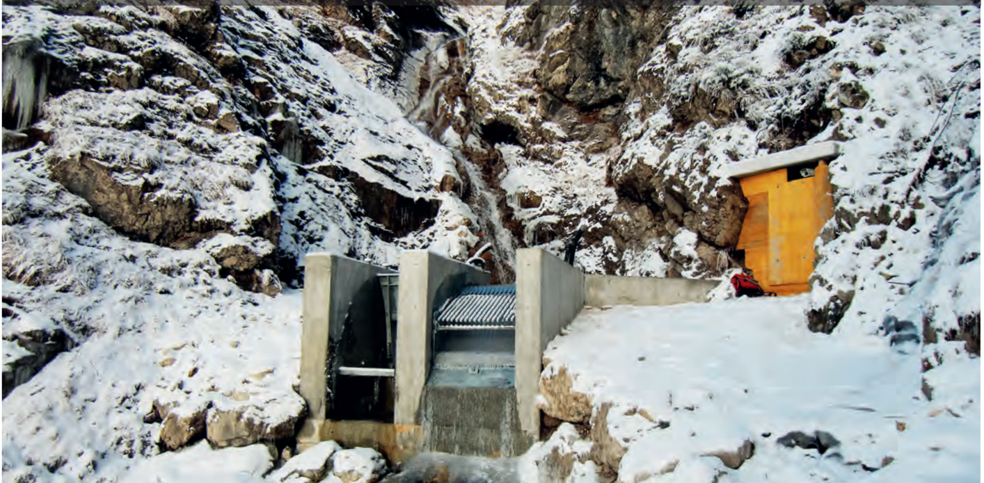
An der neuen Wasserfassung auf 1.438 m ü. M. sorgt das selbstreinigende Coanda-System „GRIZZLY“ von der Südtiroler Wild Metal GmbH für optimale Zuflussbedingungen.
