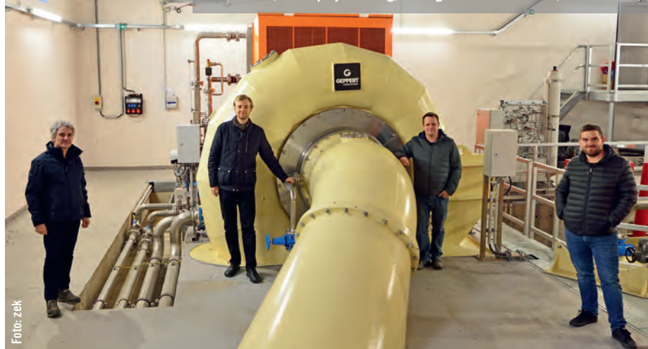
Gebündelte Fachkompetenz in der Projektleitung der Kelag (v.l.n.r.): DI Dr. Peter Marek (Elektrotechnik), DI Johannes Klausner (Maschinenbau), DI Jörg Friedrich (Gesamtprojektleitung) und Ing. Michael Kandutsch (Maschinenbau).
