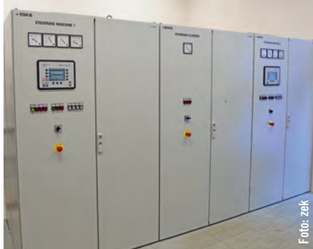
Leittechnik-Schaltschranke im Krafthaus: Die gesamte Betriebsführung liegt in den Händen der Kelag.
