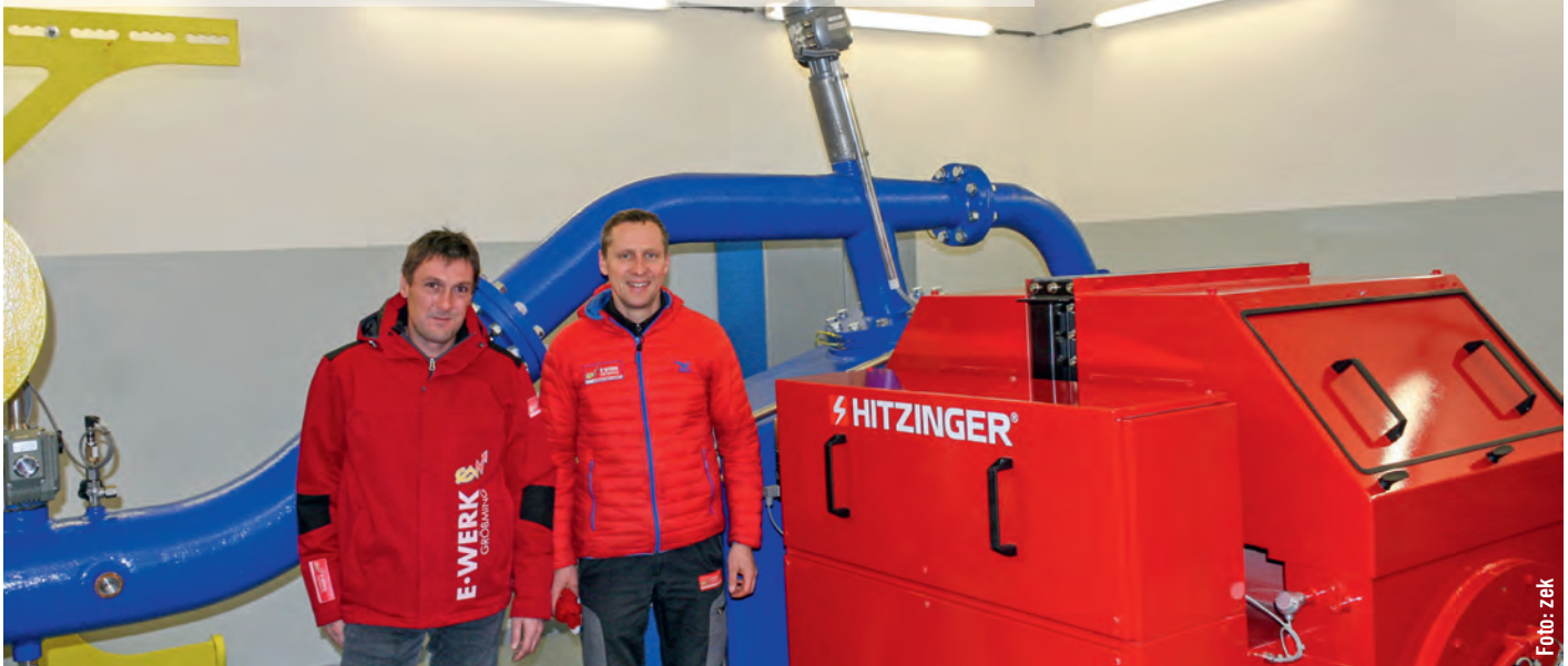
Der technische Betriebsleiter des E-Werk Gröbming Gerhard Seebacher (li.) und Helmut Walcher vom Kraftwerks-Service vor dem Herzstück der rundum erneuerten Anlage am Plöschmitzbach. Die 3-düsige Pelton-Turbine vom Tiroler Wasserkraftspezialisten Geppert GmbH schafft bei vollem Wasserdargebot eine Engpassleistung von 554 kW.
