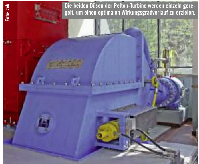
Der neue Maschinensatz wurde äusserst platzsparend im noch verbleibenden Raum der Maschinenhalle Lügen positioniert.
