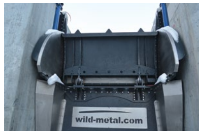
Schütze mit aufgesetzter Stauklappe / Paratoia con sovrapposta paratoia a ventola
