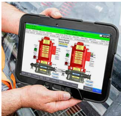
Steuerung der gesamten Kraftwerkanlage per Tablet-Computer.
